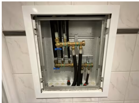
Fordelerskap i bad.
